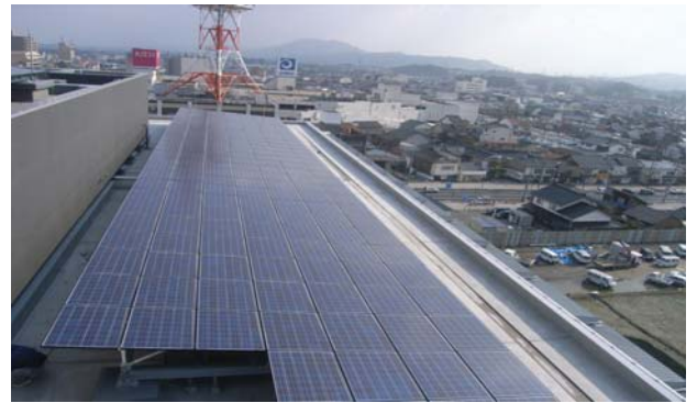
市役所屋上の太陽光パネル
